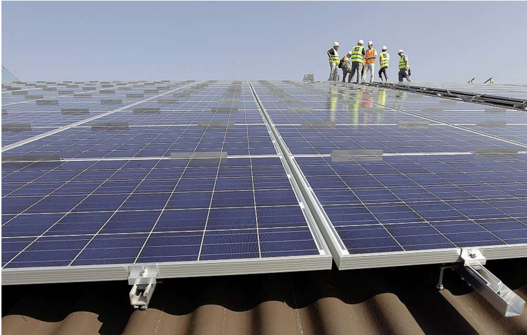
Solarzellen auf dem eigenen Dach: Mit einem Energieförderfonds wollen die Gemeinden Thun, Steffisburg, Uetendorf und Heimberg Anreize schaffen, energieeffizient zu bauen.
